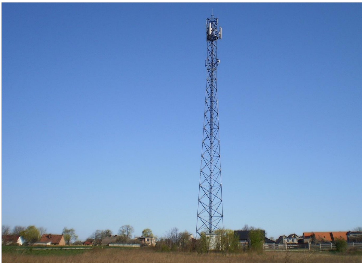
Fot. 5.1. Maszt stacji bazowej telefonii komórkowej w Gułtowach (fot. Piotr Guziński)
