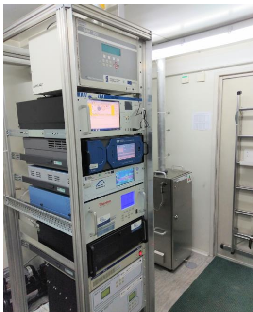
Fotografia 2.1. Aparatura pomiarowa na stacji w Białymstoku przy ul. Waszyngtona.
