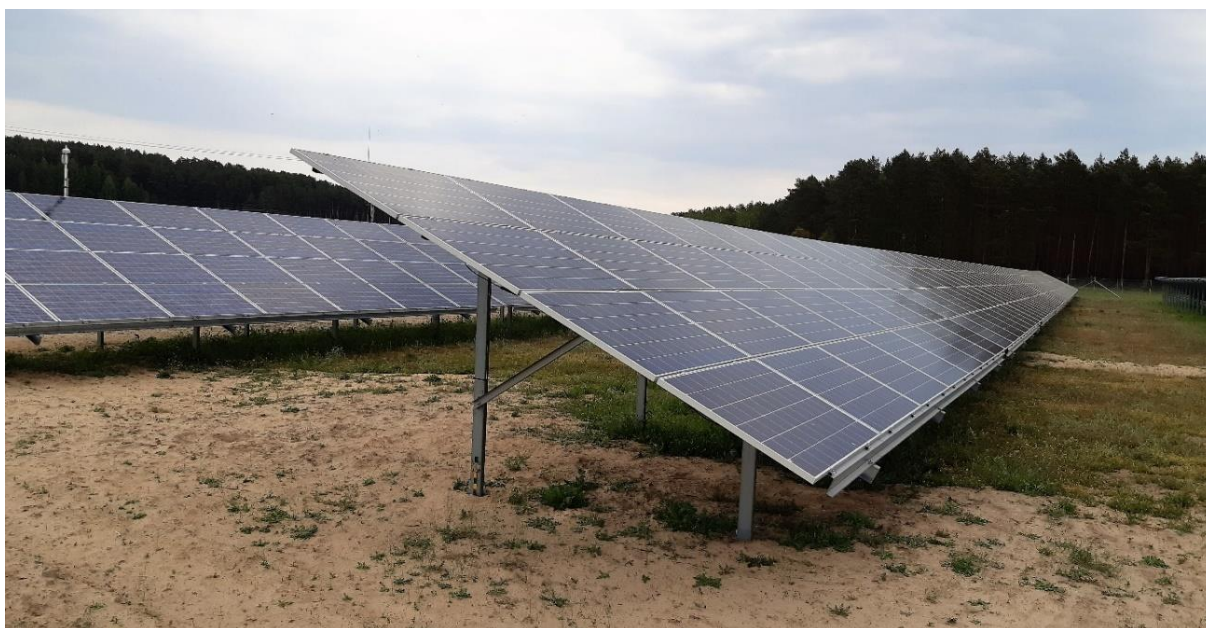
Fotografia 1.4. Elektrownia słoneczna koło Gądkowa Wielkiego, gm. Torzym (fot. Przemysław Susek)
