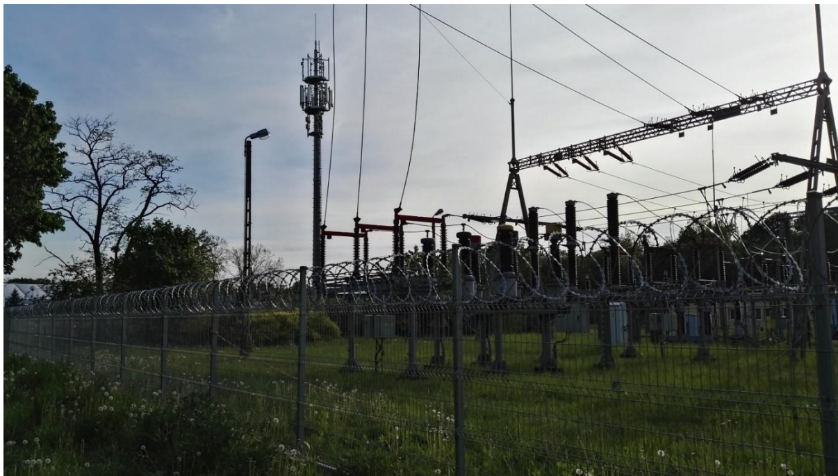
Fotografia 7.1. Rozdzielnia energetyczna i stacja bazowa telefonii komórkowej zlokalizowana we Wrocławiu przy ul. Spiskiej (fot. Krzysztof Antosz)
