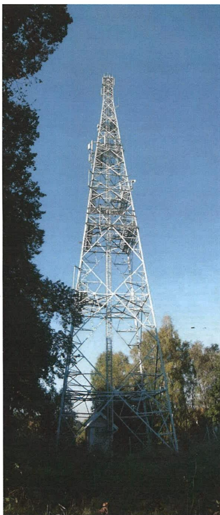
Stacja bazowa w miejscowości Trzebiel (fot. Przemysław Susek)
