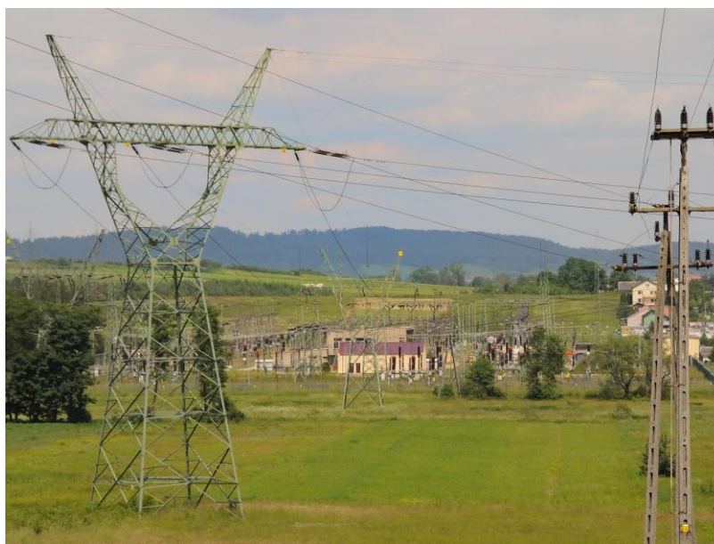
Rys. 3.1.3 Góry Świętokrzyskie. Widok stacji elektroenergetycznej 220/110/15 kV wraz z liniami 220 kV i 15 kV. Fot. Stefan Różycki
