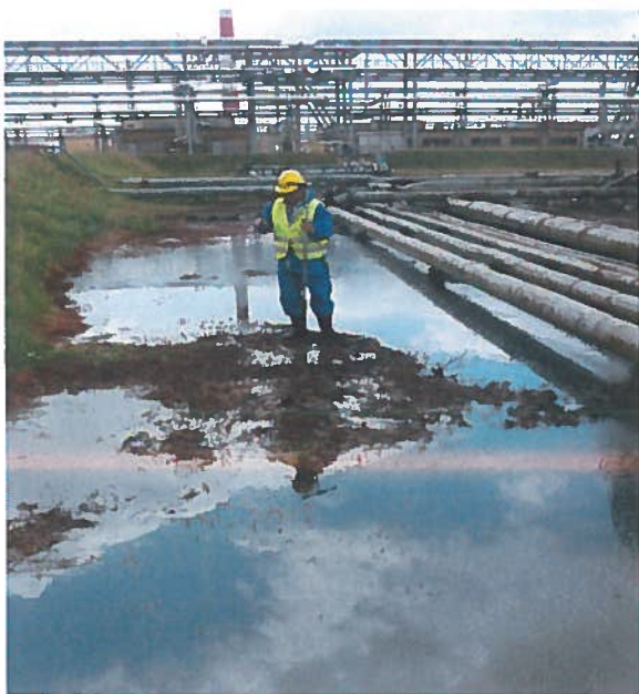
Rozlewisko ciężkiego oleju opałowego w obrębie ziemnego obwałowania zbiornika magazynowego
