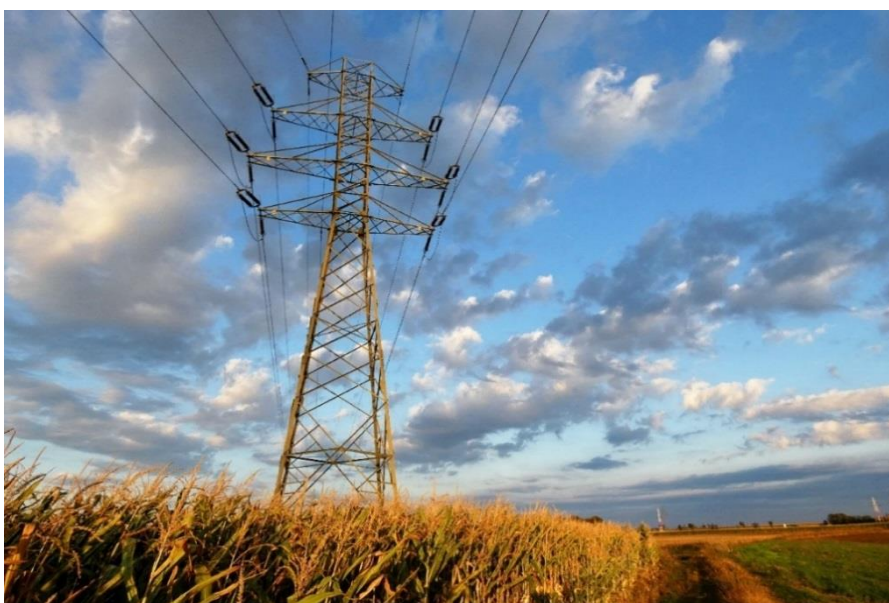
Fot. 5.1. Linia elektroenergetyczna napowietrzna (źródło: A. Sałek, WIOŚ w Opolu)
