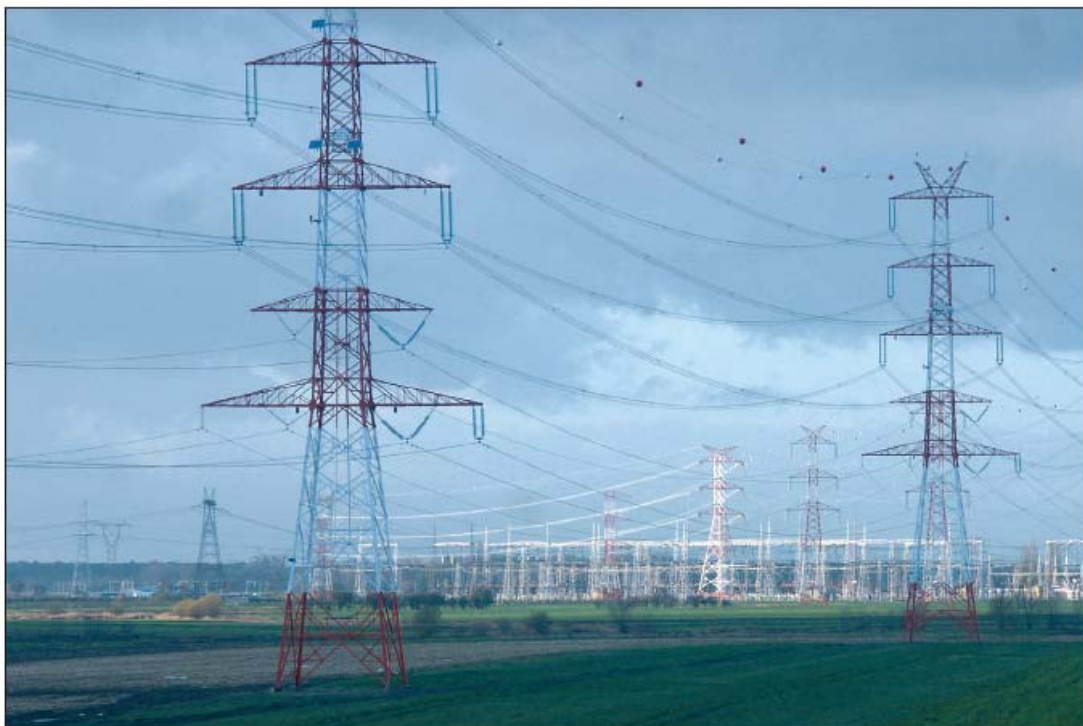
Zdjęcie 7.1 Linie elektroenergetyczne i w tle stacja elektroenergetyczna [23].
